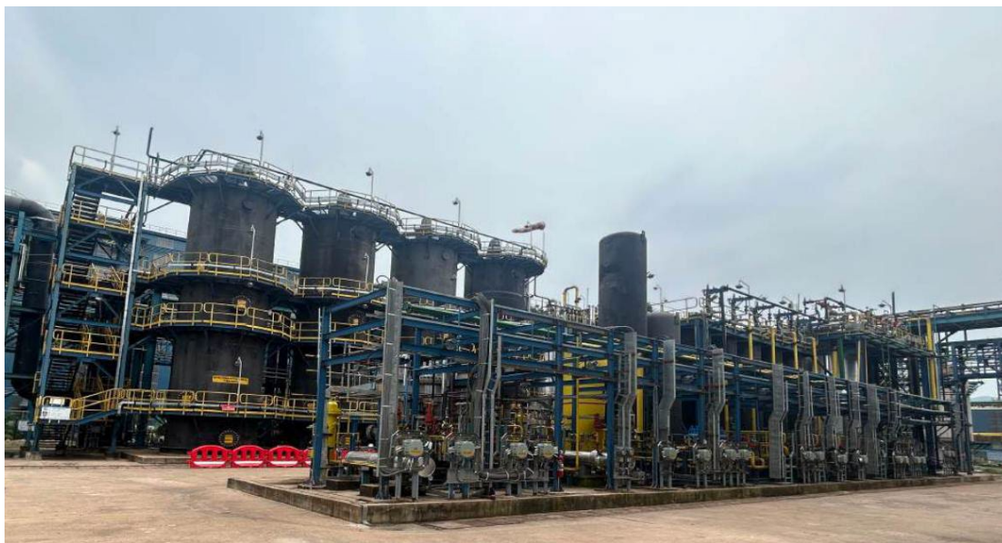
Image : Système d'épuration des gaz de cokerie et d'extraction de l'hydrogène de PyroGenèse chez Tata Steel, à Kalinganagar, en Inde.
